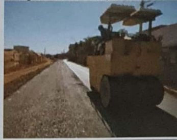
Pavimentação asfáltica nos Cond. Embaré e São João, nas margens da VC 311, Trecho II
